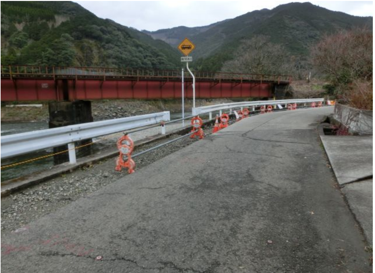
〈道路嵩上げ工事に係る既存階段等の擦り付け予定箇所の近況〉（平成 26 年 1 月） 【A-⑦】
