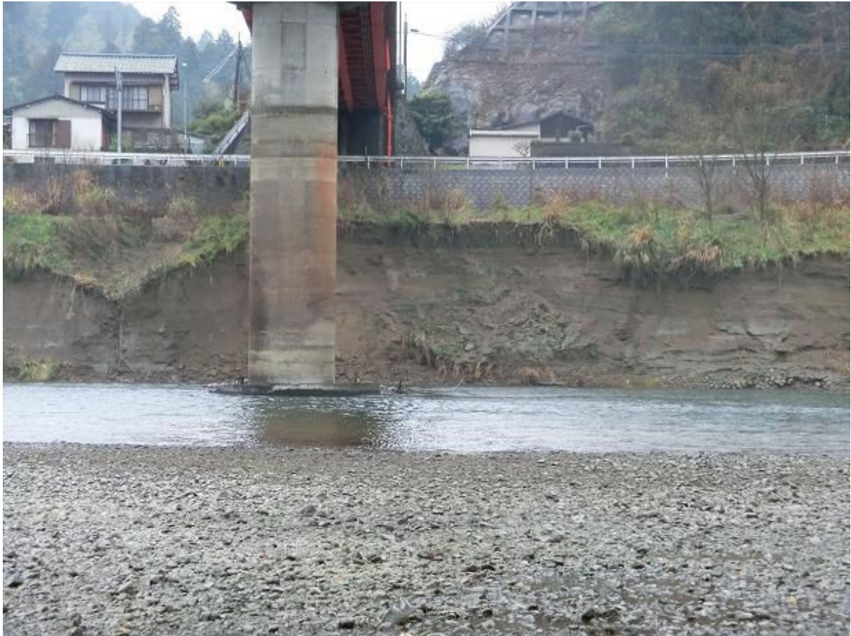
〈葉木橋付近の護岸の洗掘状況〉（平成 26 年 1 月）
