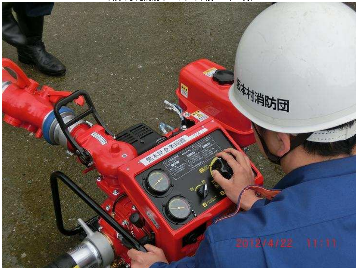
〈導入した消防ポンプ〉（平成 24 年 3 月）
