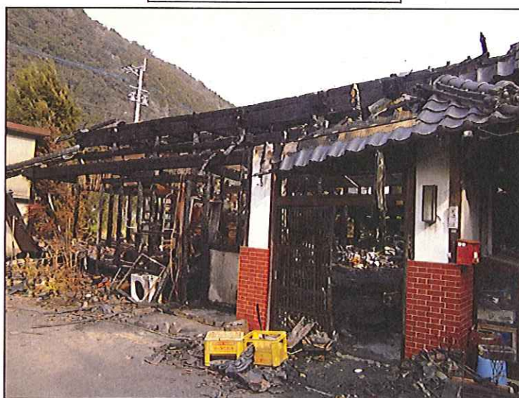
火災現場写真
