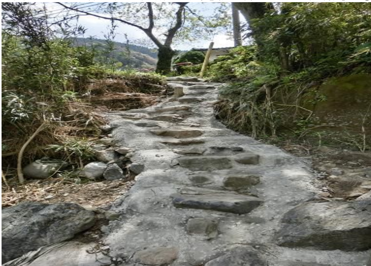
〈中津道地区河川への降り道〉 H25 年 1 月発生の火事を踏まえ手直し（平成 25 年 3 月）【A-⑩】
