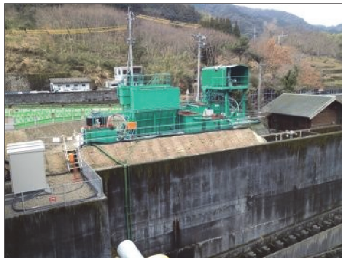
写真- 2.1 濁水処理設備の設置状況
