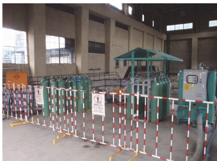
写真- 2.209 pH 処理設備設置状況（第Ⅳ期及び第Ⅴ期）
