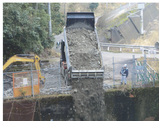
(取水口部から投入)
