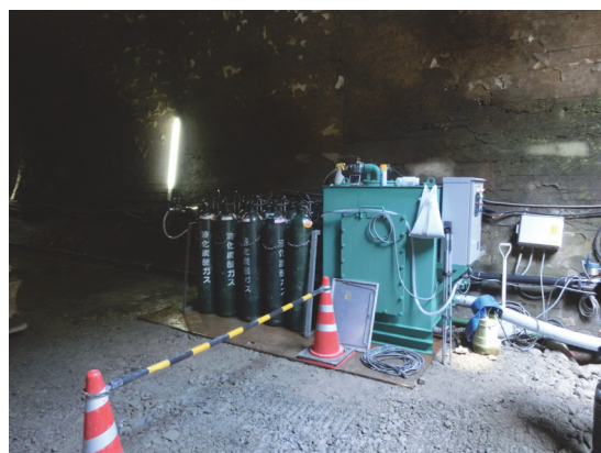
写真-2.208 pH処理設備設置状況（第Ⅲ期）
