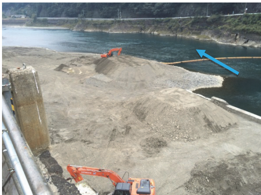
写真- 2.154 ダム直下流土砂の集積状況
