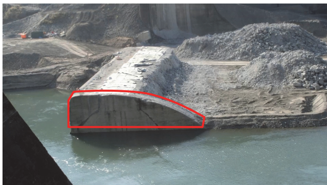
写真- 2.156 みお筋側 2m の一時残存状況
