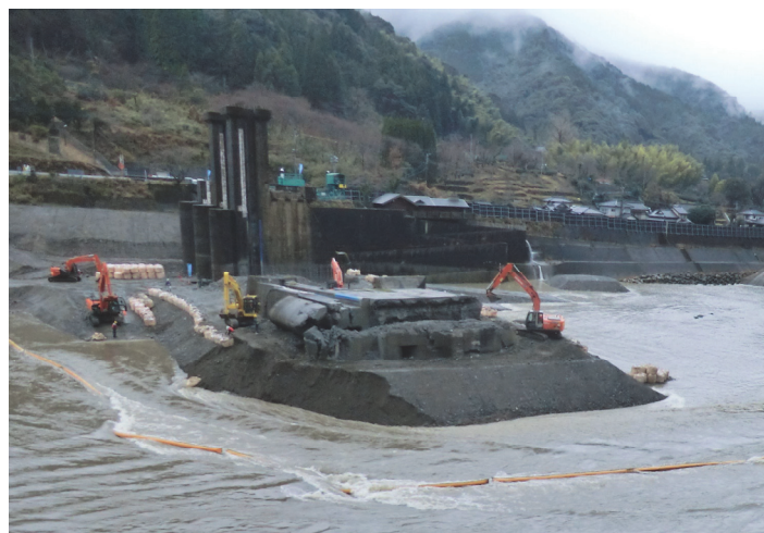
写真- 2.143 P6倒壊後の出水の状況 (H28.1.29)
