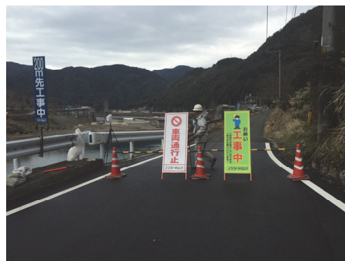
写真- 2.147 通行止めの状況（県道）
