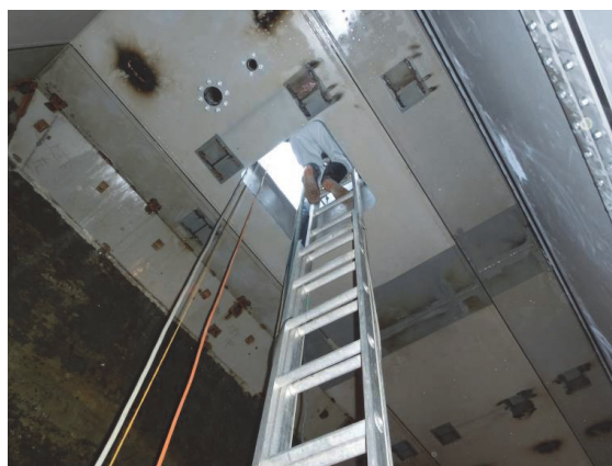
(マンホールからの降下タラップ)
