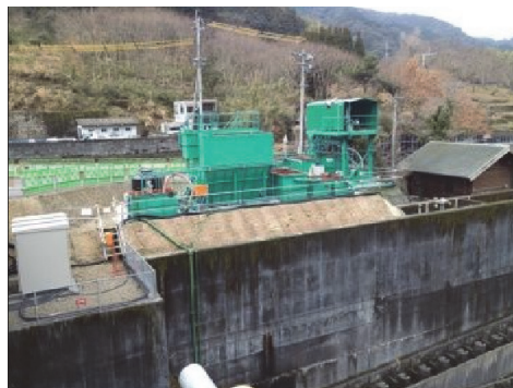
写真- 2.37 濁水処理設備の設置
