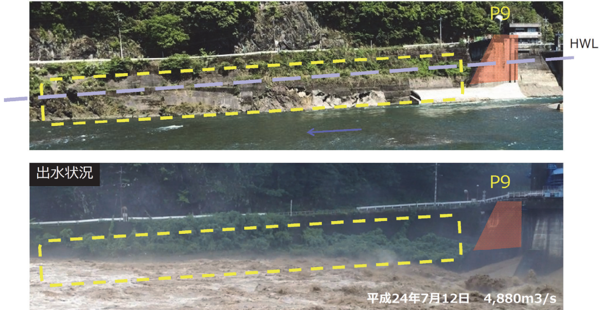
写真-1.4 出水時の右岸下流護岸の状況
