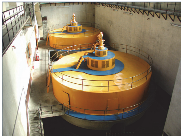
写真- 3.2 発電機の状況
