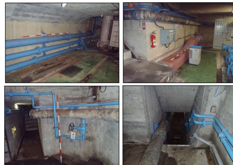
冷却水管 狀況写真
