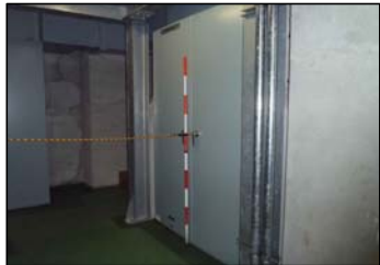
取引用CT盤 状況写真
