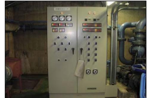
給水ポンプ制御盤 状況写真
