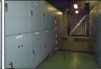
3.3kV所内変電設備 状況写真
