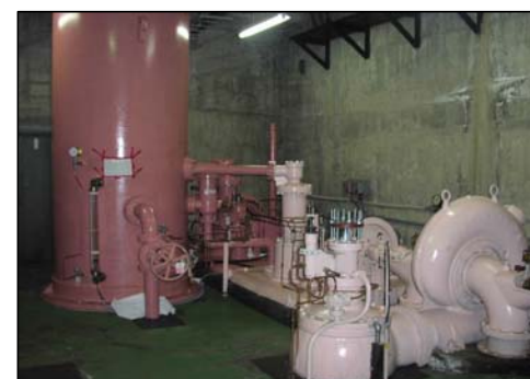
油圧タンク・小水車 状況写真
