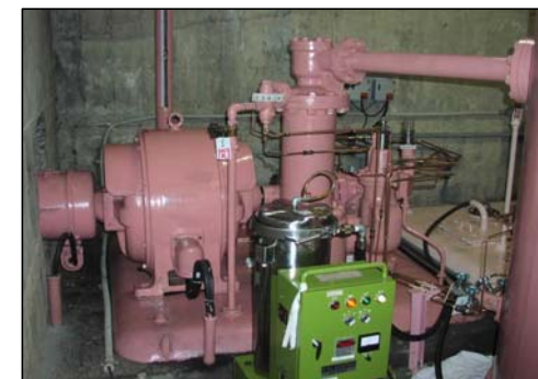
油圧ポンプ 状況写真
