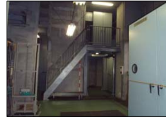
計器用変成器盤用架台(中段2階) 状況写真
