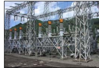
CT 外形図・状況写真
