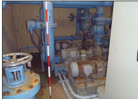
給水ポンプ 状況写真
