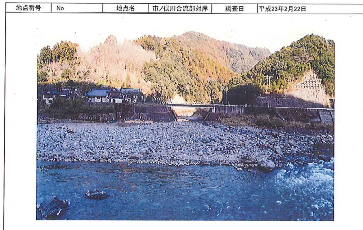
図 2-2-109 市ノ俣川合流部対岸における河道内の現況
